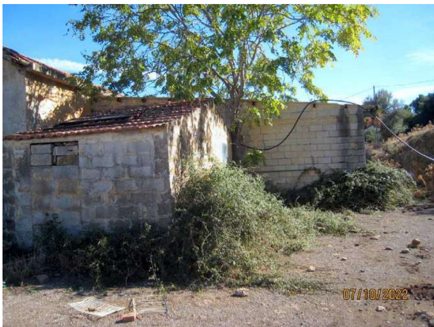
Foto n. 93. Casetta parzialmente abusiva.
