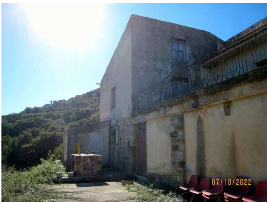
Foto n. 104. Il prospetto Nord-Est è in cattive condizioni ed intriso di umidità.
