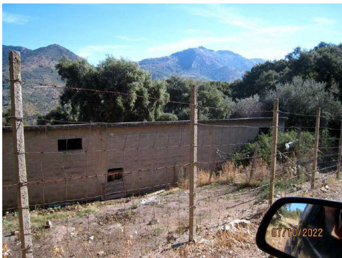
Foto n. 96. Il fabbricato distinto con la p.lla 333 risulta abusivamente costruito.
