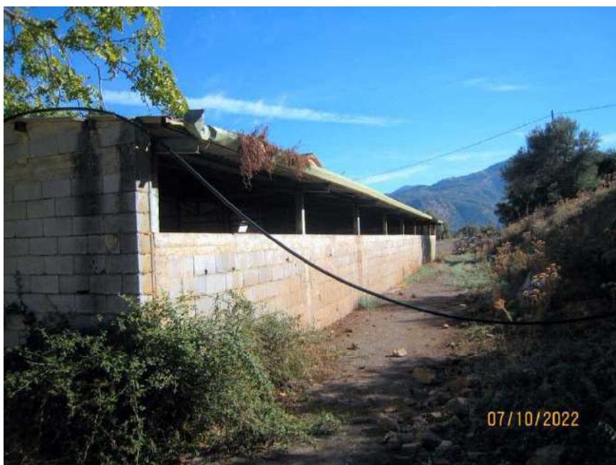
Foto n. 94. Ampliamento Sud abusivo.
